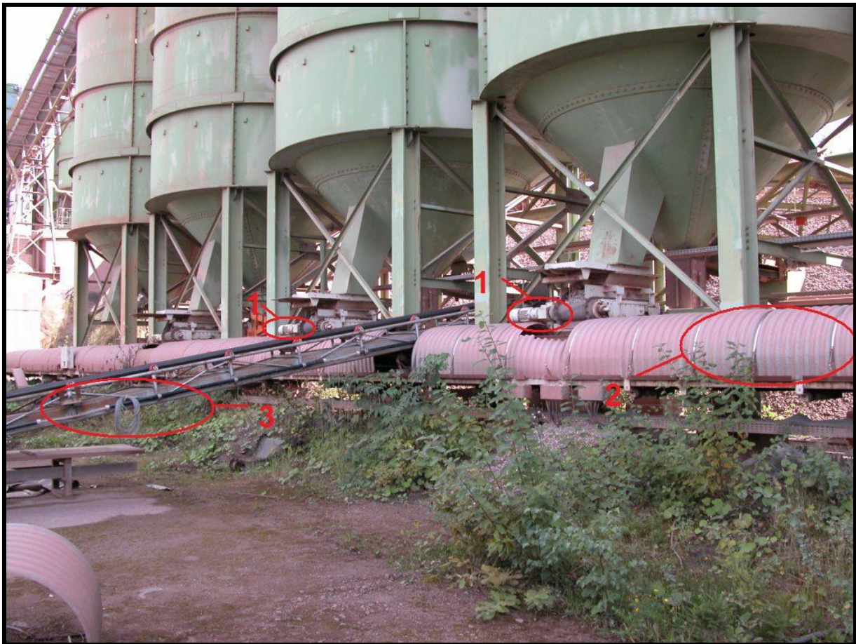
Silolanlage mit Förderbändern
