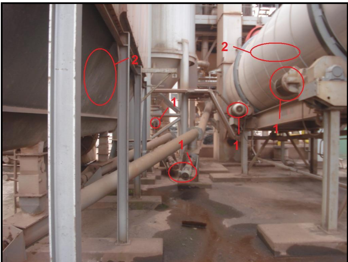
Elektromotoren und Rohrverbindungen in Aufbereitungs- und Mischanlagen
