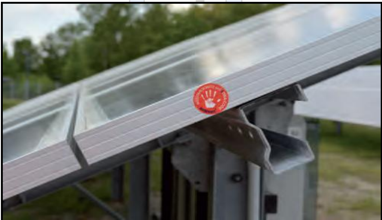
Aufkleber auf Photovoltaikmodul
